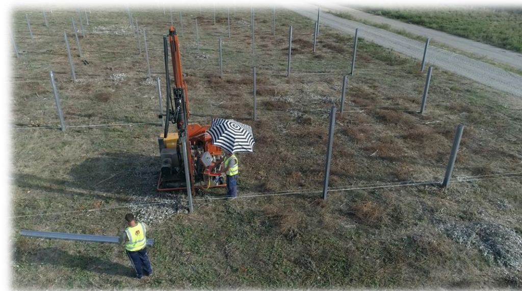
Exemple d'un chantier de battage de pieux pour parc photovoltaïque au sol (source : https://www.dronesudtoulouse.fr/ )
